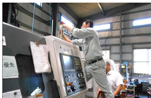
設備に光センサーもしくはリミットスイッチを設置
